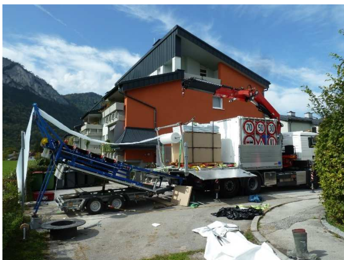
Spezialgerät mit Standplatz in der Jellmollistraße
